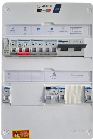
Coffret 3,6/6 kVA monophasé avec inverseur de source manuel · IP 30 Circuit secouru indépendant
